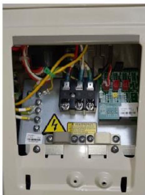
Wygląd części elektrycznej jednostki zewnętrznej (zdjęcie powyżej)
