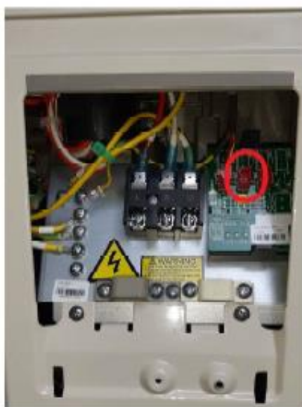
Jednostka zewnętrzna pompa ciepła
